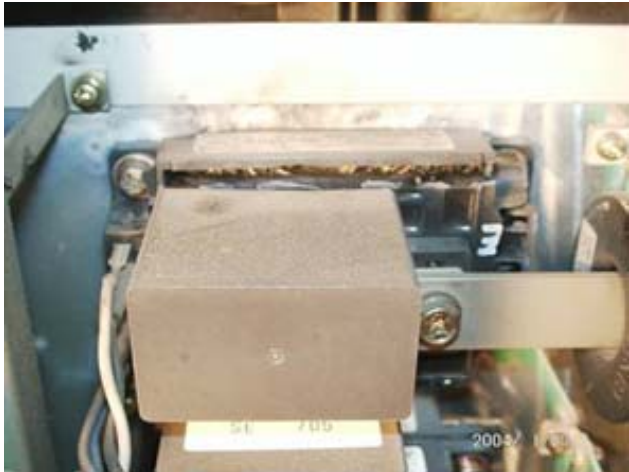
電力素子損傷（測定1ヵ月後）
